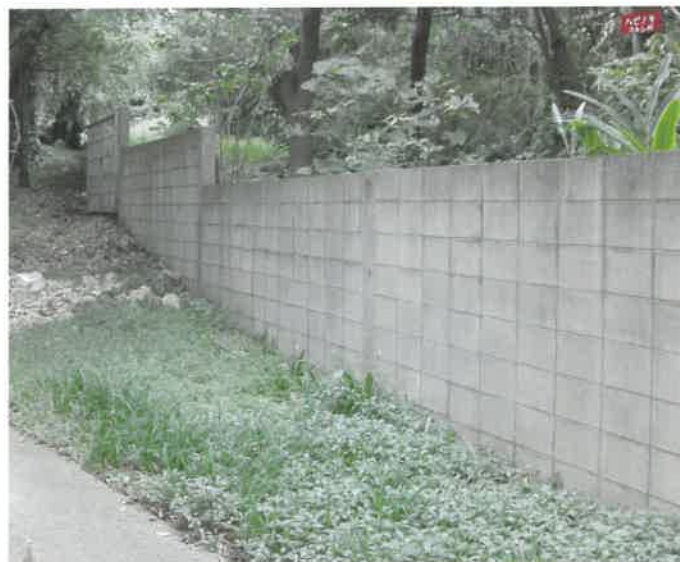
ハブの侵入を防ぐブロックべい
